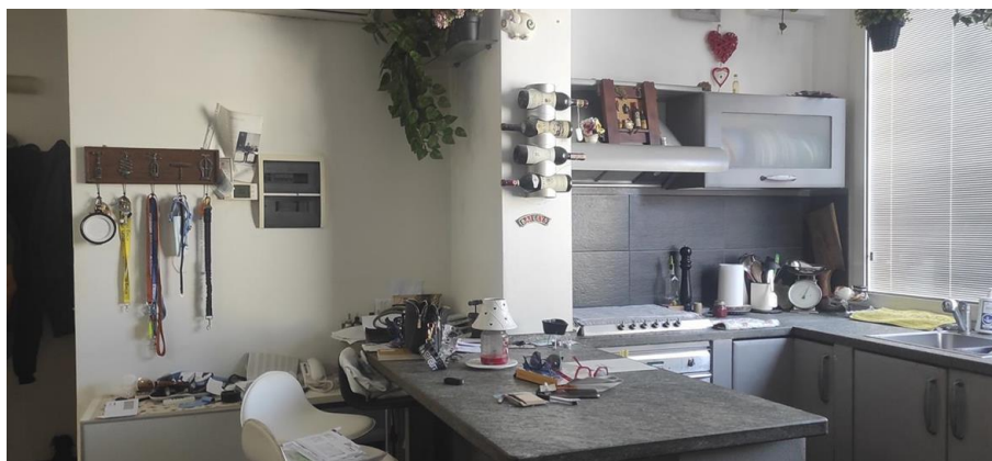
Figura 13: Interno 1 – Angolo cottura difforme dallo stato legittimato
