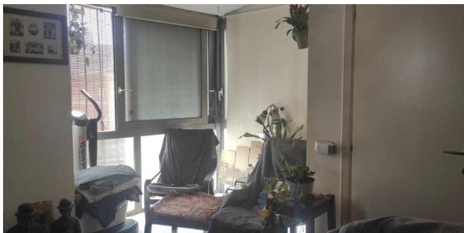
Figura 14: Interno 2 – Veranda difforme dallo stato legittimato
