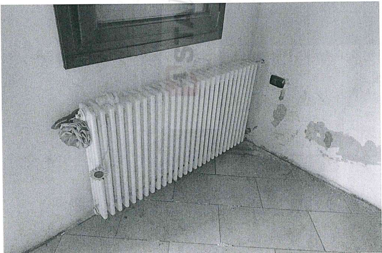
Foto 34 - Particolare impianto termoidraulico
