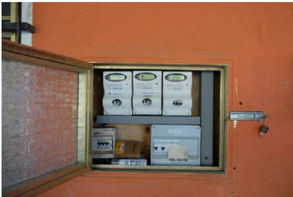
veduta della nicchia dei contatori della luce, ubicata sotto al portico tra le porte di accesso alle unità abitative esistenti nell'intero fabbricato
