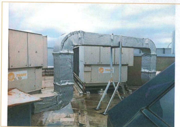
Vista impianti condizionamento (copertura)
