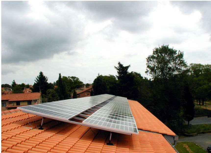
ESEMPIO DI PANNELLI FOTOVOLTAICI INSTALLATI SUL TETTO DI UN EDIFICIO
