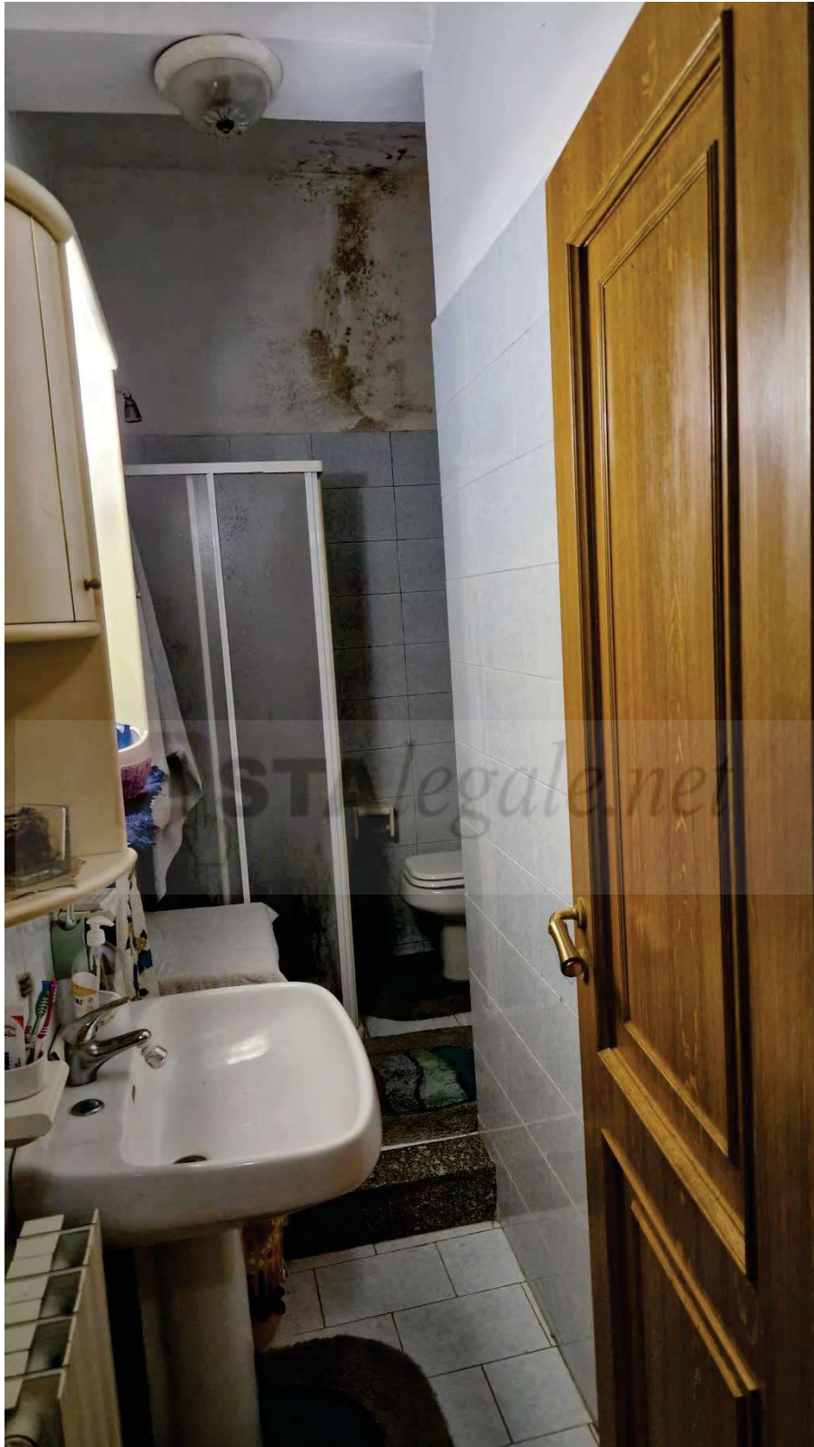
Foto n. 2 – bagno n. 1 – umidità sulla parete
