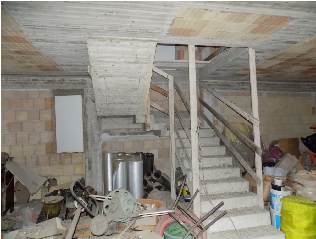
Piano Primo – stato attuale – scala di collegamento interna fra P1 e P2
