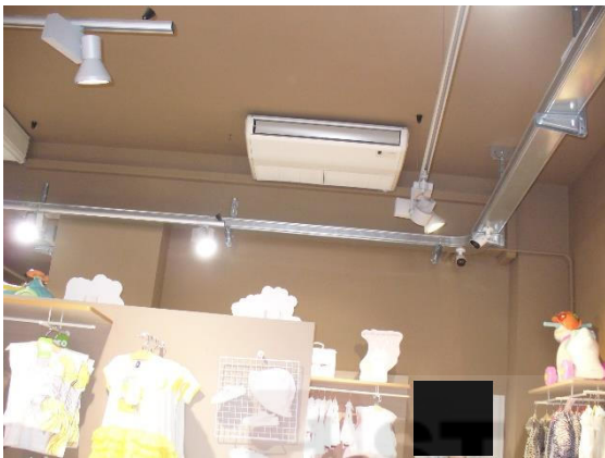
FOTO N. 42 – impianto di illuminazione e condizionatore-
