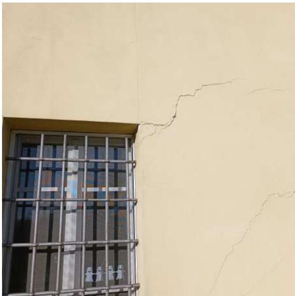
Crepe sul perimetro della finestra
