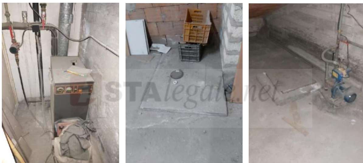
Foto n. A.12, A.13 e A.14 : Foto rispettivamente da sinistra verso destra : Caldaia, serbatoio di gasolio, cisterna idrica e la pompa di sollevamento.
