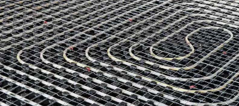
Impianto di riscaldamento
