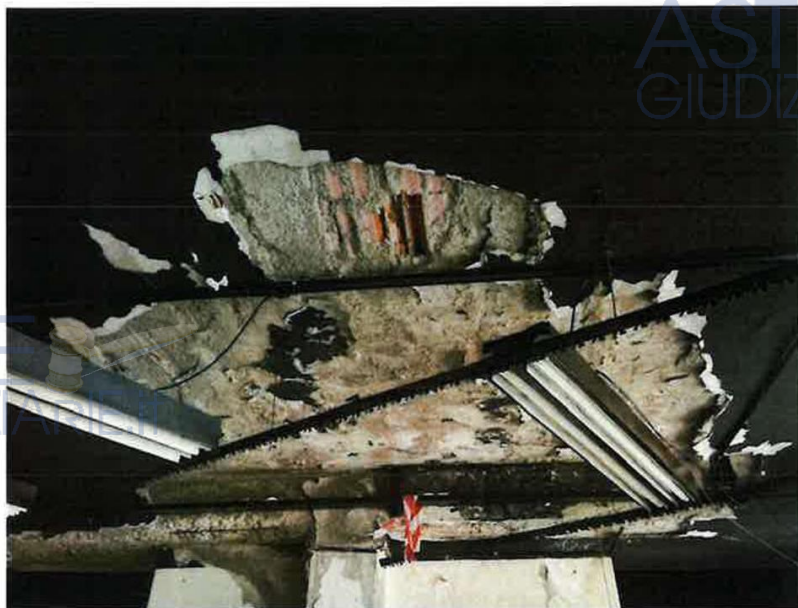
PARTICOLARE SOFFITTO DETERIORATO
