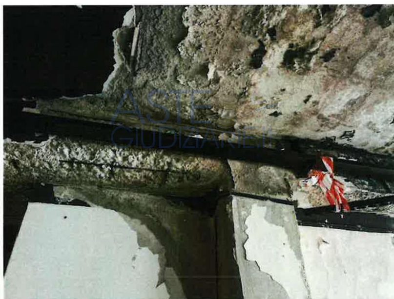
PARTICOLARE STRUTTURA DETERIORATA
