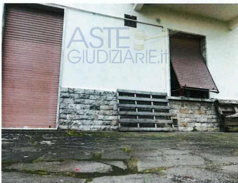
TERRAZZO PARTICOLARE PUNTO INFILTRAZIONI
