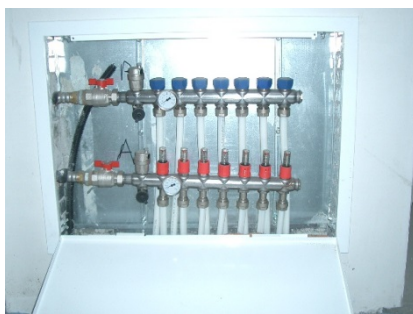
COLLETORE PANNELLI RADIANTI
