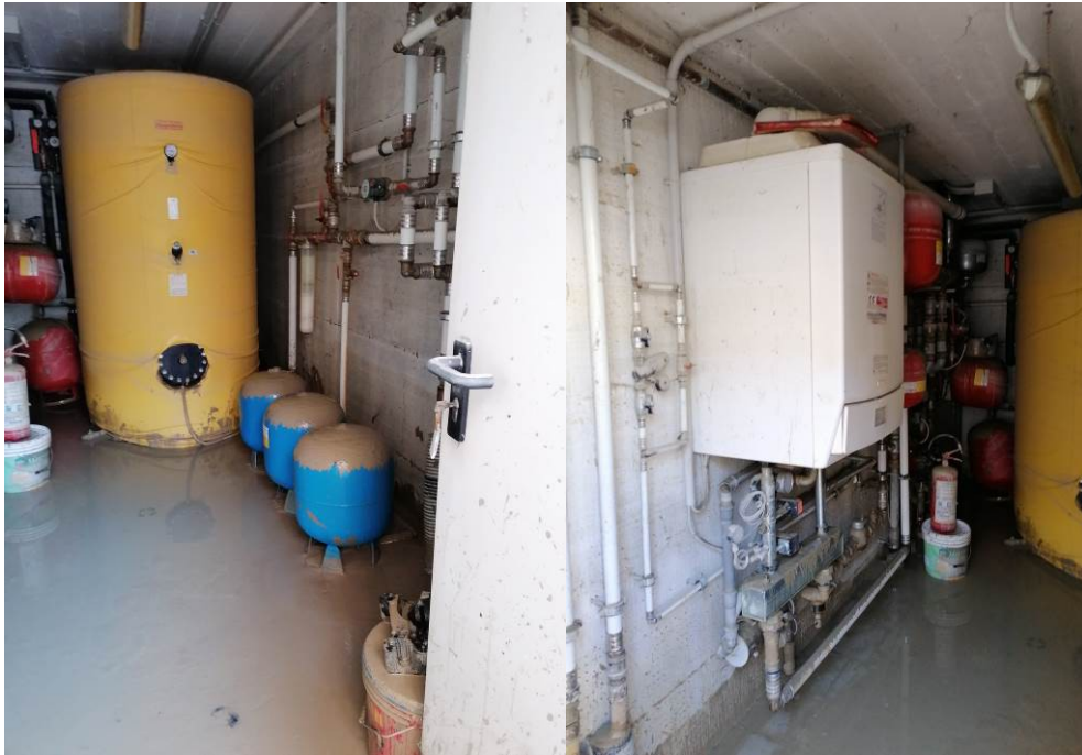
Vista della centrale termica condominiale comune ai blocchi 1 e 2
