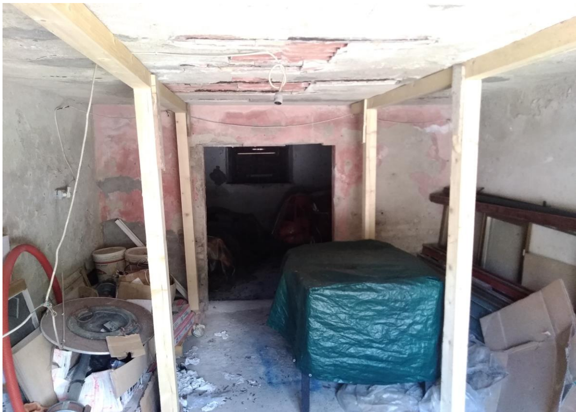
FOTO 8- Vista interna magazzino – civico 32 – la foto evidenzia la puntellatura del solaio sovrastante nonché i vari distaccamenti e crolli degli intonaci del soffitto
