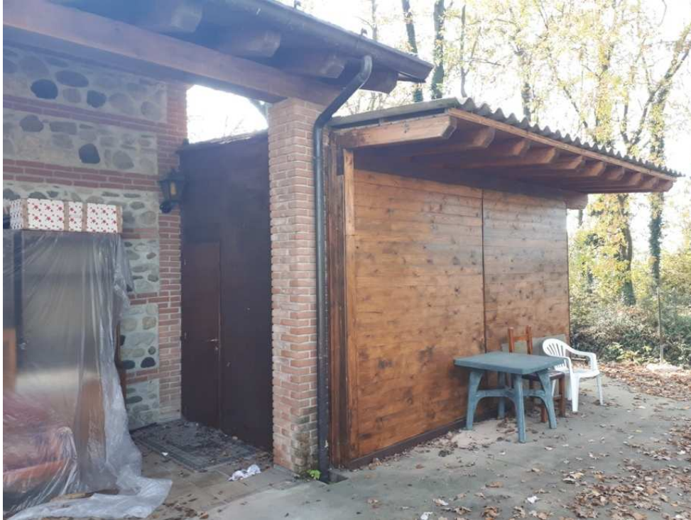
FOTO BENE B.1 – Deposito piano terra, particolare di struttura in legno non autorizzata
