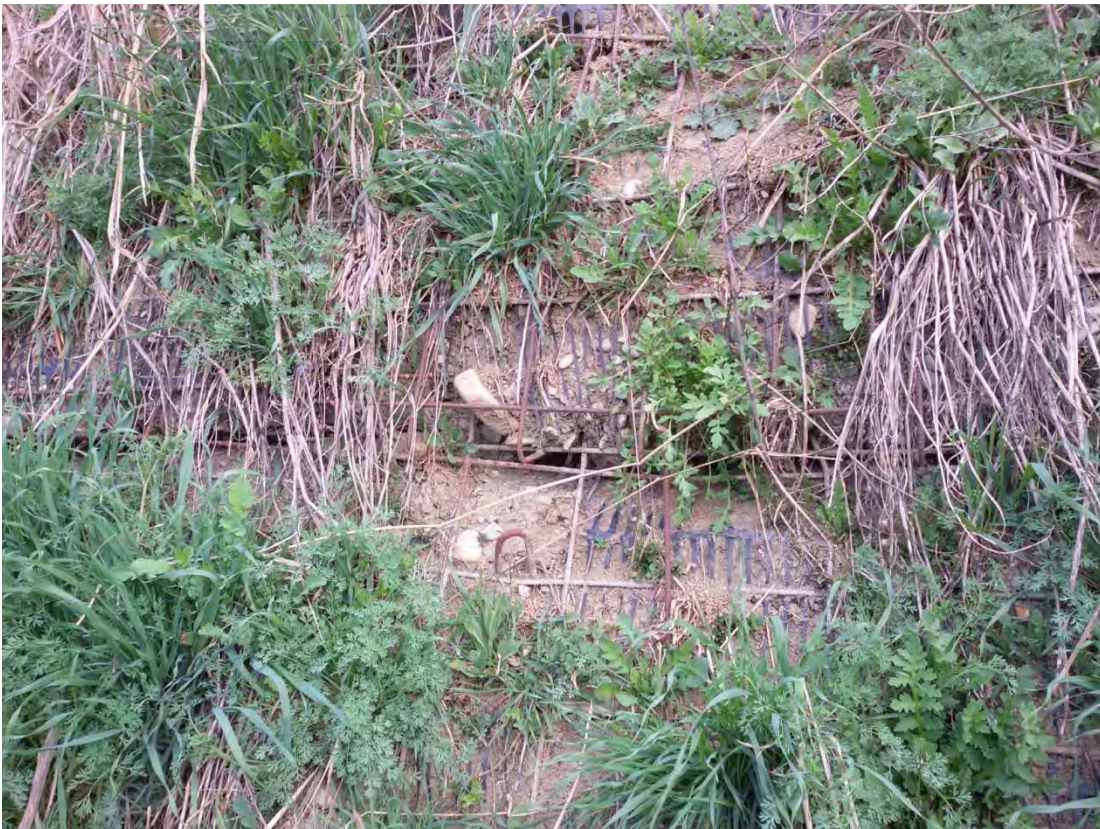
14. Particolare barriera antirumore.
