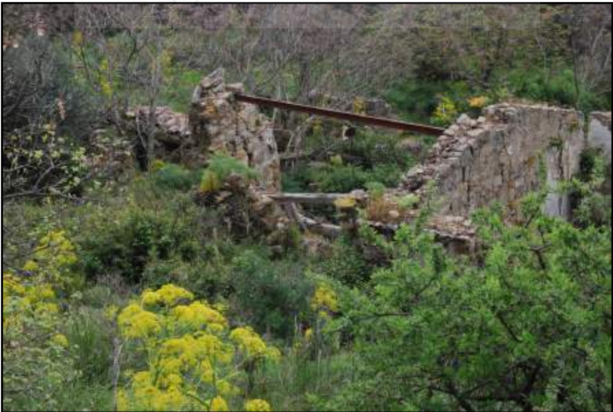
FOTO 83 – Nicosia - Foglio 59 – Particella 129 – Fabbricato rurale diruto di Contrada Spirini
