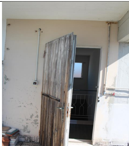
PORTA DI ACCESSO AL TERRAZZO. SI NOTANO L'INTERRUTTORE ELETTRICO (a sinistra) e LA TUBAZIONE DI ADDUZIONE ACQUA (a destra)
