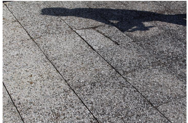
PARTICOLARE DELLA PAVIMENTAZIONE CON ALCUNE PLOTTE ROTTE
