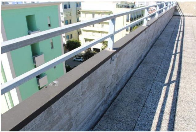
PARTICOLARE DEL PARAPETTO CHE HA LA MURATURA INCLINATA VERSO L'INTERNO
