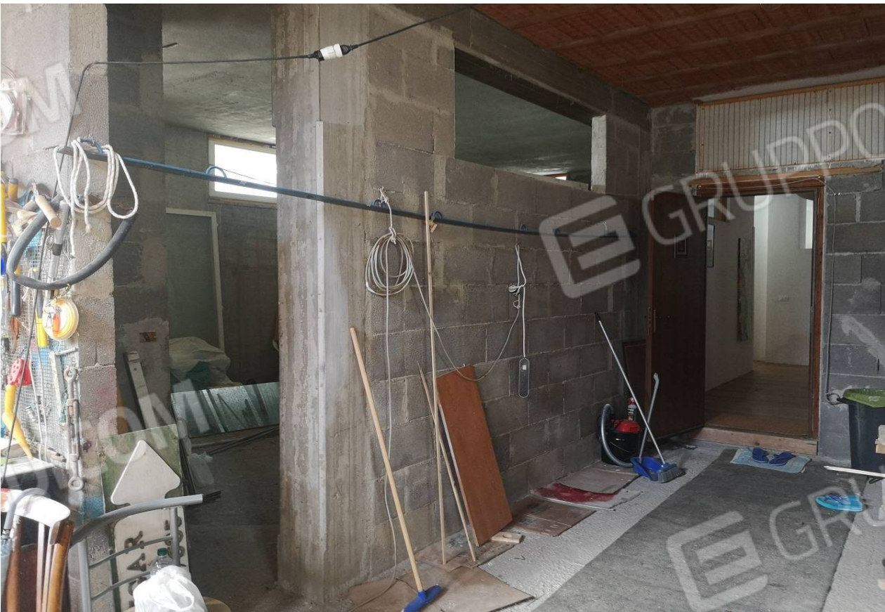
Foto 59. PS1: vani componenti il piano seminterrato, con accesso da interno e esterno, tuttora al rustico
