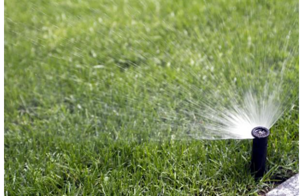
1 Impianto di irrigazione del verde condominiale
