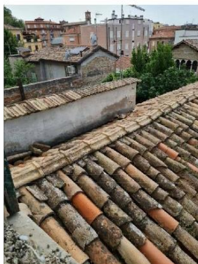
FOTO 84 - INFILTRAZIONE TETTO FABBR. A SERVIZI
