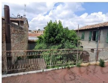
FOTO 92 - VISTA CANNA FUMARIA CENTRALE TERMICA
