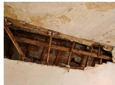
FOTO 74 - PORZIONE COPERTURA DEGRADATA
