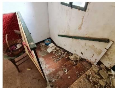
FOTO 73 - MACERIE DEL CROLLO STRUTTURALE
