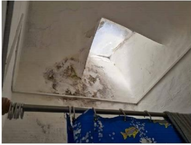
FOTO 78 - ALA A SERVIZI INFILTRAZIONI LUCERNAIO
