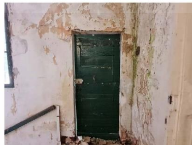
FOTO 76 - ALA A SERVIZI INFILTRAZIONI DALLA COPERTURA
