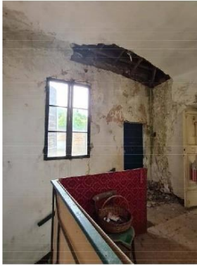
FOTO 68 - ALA SERVIZI DEGRADO COPERTURA
