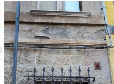
FOTO 96 - FACCIATA PRINCIPALE USURA E DISTACCHI
