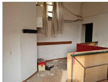
FOTO 97 - ALA A SERVIZI CON PROBLEMI STRUTTURALI
