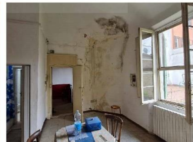
FOTO 77 - ALA A SERVIZI CUCINA CON INFILTRAZIONI
