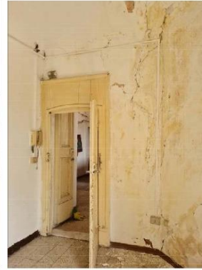
FOTO 70 - INFILTRAZIONI DA COPERTURA
