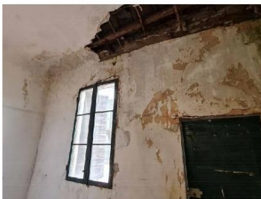
FOTO 72 - ALA SERVIZI PORZIONE DI COPERTURA CROLLATA
