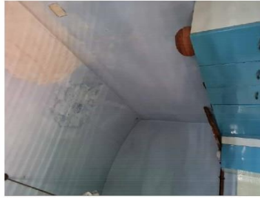
FOTO 79 - UMIDITA' DA CONDENZA
