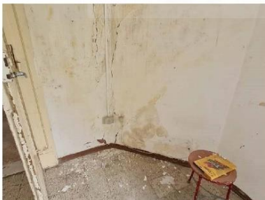
FOTO 75 - ALA A SERVIZI INFILTRAZIONI E UMIDITA'
