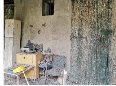
FOTO 80 - PIANO INTERRATO DEGRADO, INFILTRAZIONI E UMIDITA'
