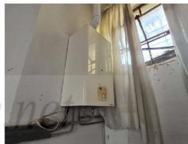
FOTO 93 - CALDAIA FABBRICATO A SERVIZI
