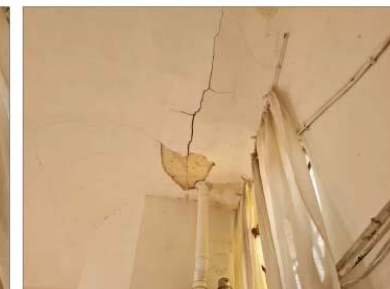
FOTO 99 - CONTROSOFFITTO A RISCHIO CROLLO
