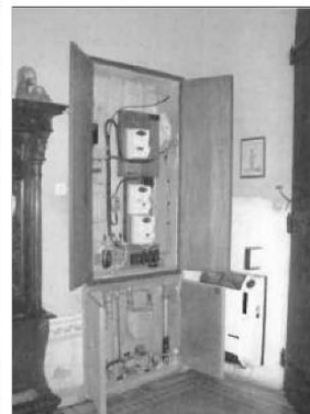
FOTO STORICA - VANO CONTATORI
