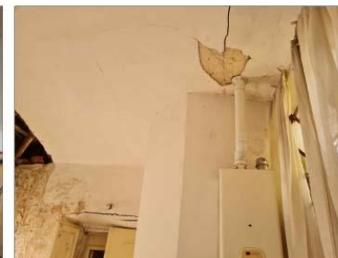
FOTO 98 - PORZIONI DI CONTROSOFF. AMMALORATE A RISCHIO CROLLO
