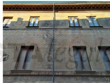
FOTO 95 - FACCIATA PRINCIPALE USURA E DISTACCO VERNICIATURA
