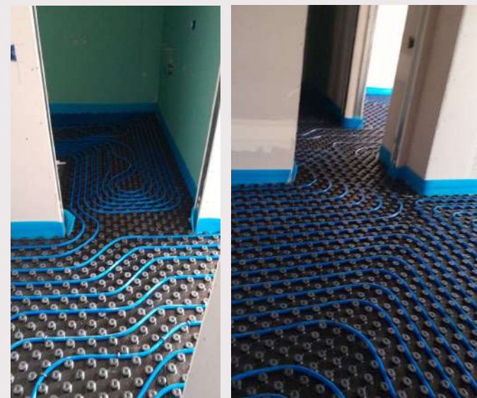
Figura 38 – Impianto radiante realizzato in altro cantiere
