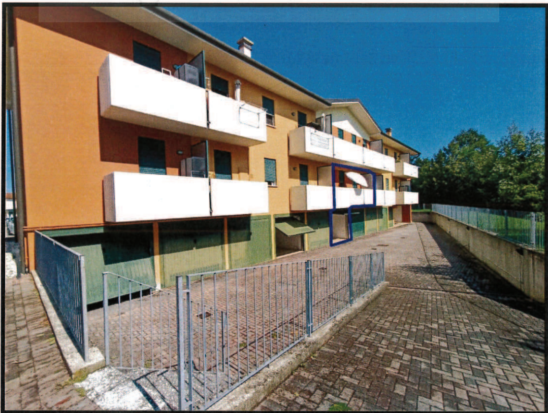
Foto n. 2: Vista appartamento al piano terra ed autorimessa al piano interrato, prospetto Est.
