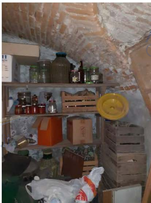
FOTO 7 – RIPRESA FOTOGRAFICA EFFETTUATA DAL C.T.U.
