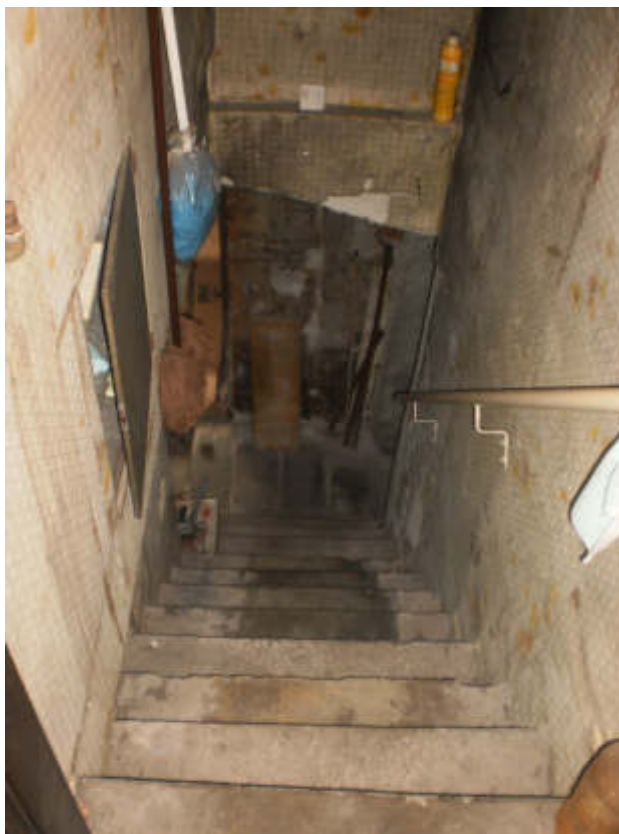
FOTO 47 Vista interna PS1 – Scala per accesso a Cantina
