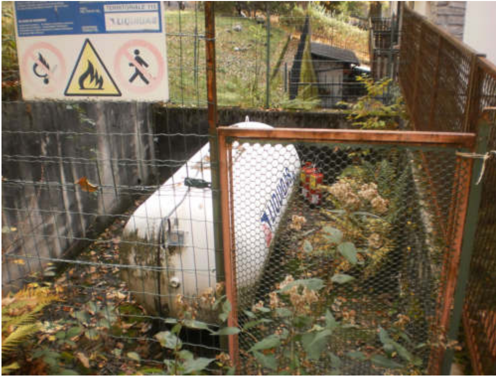
FOTO 81 Vista esterna – Area scoperta con serbatoio accumulo gas.
