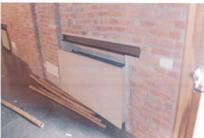
Foto 92: Part. impianto riscaldamento
