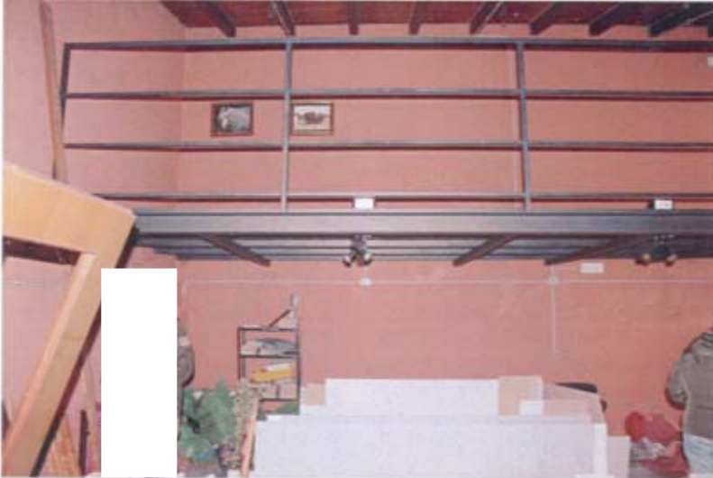
Foto 71: Deposito 1 – Soppalco da regolarizzare
