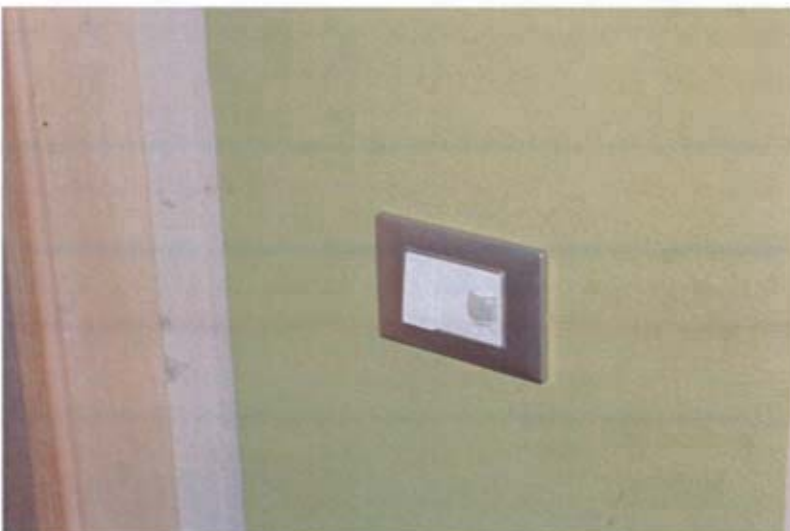
Foto 107: Part. impianto elettrico
