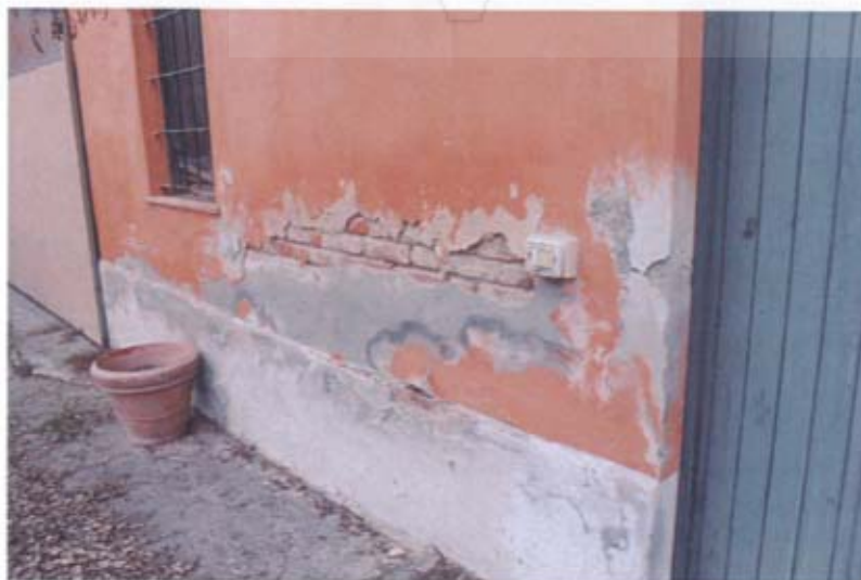
Foto 50: Part. muratura perimetrale ammalorata
