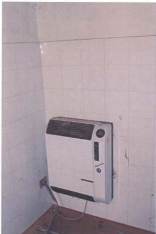
Foto 28: Part. impianto riscaldamento
