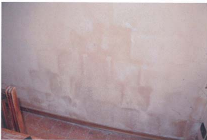
Foto 57: Part. intonaci interni ammalorati
