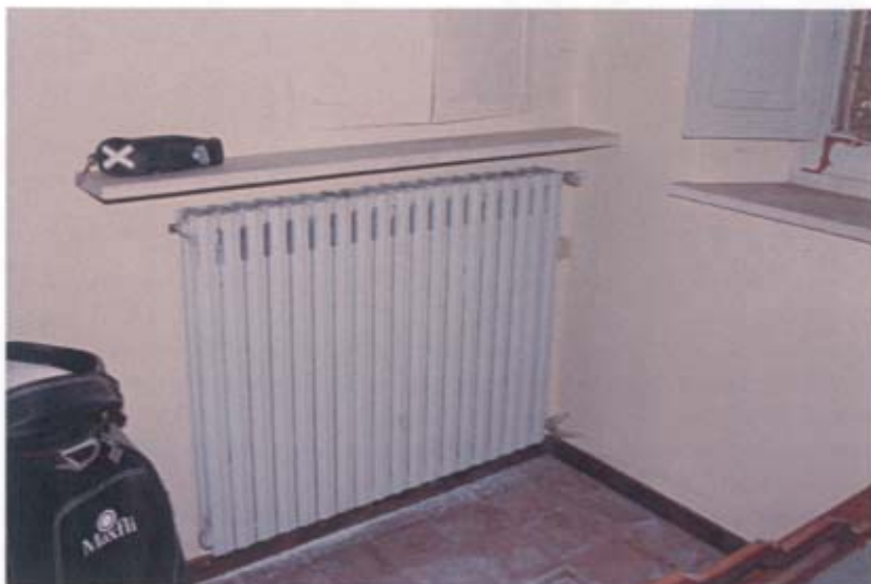
Foto 12: Part. impianto riscaldamento
