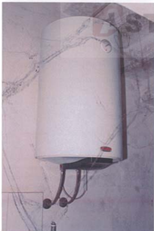
Foto 29: Part. boiler sottoscala cucina
