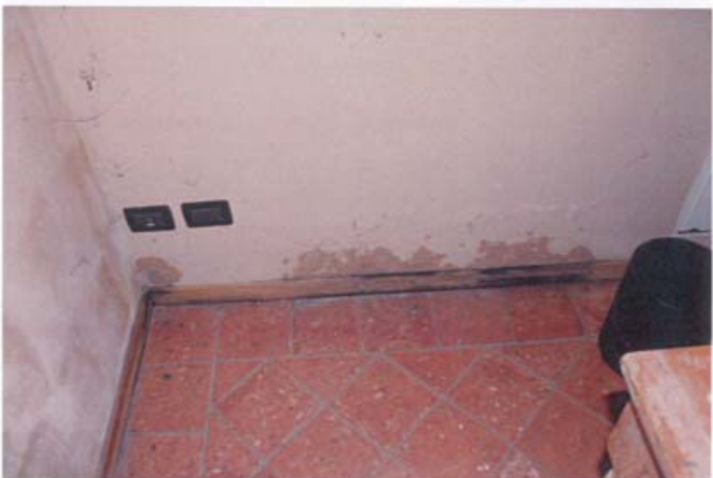
Foto 59: Part. intonaci ammalorati
