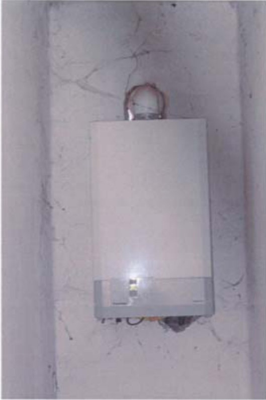
Foto 44: Part. caldaia murale interna al vano scala
