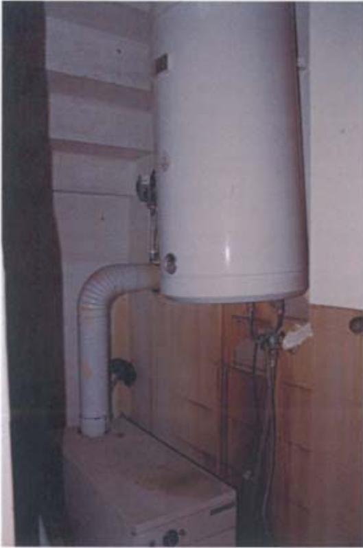
Foto 17: Part. caldaia e boiler sottoscala cucina
