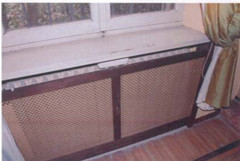
Foto 14: Part. impianto riscaldamento soggiorno
