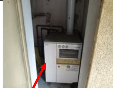
Sub 11, locale caldaia attualmente insistente su altra proprietà non oggetto di pignoramento (sub 7)
