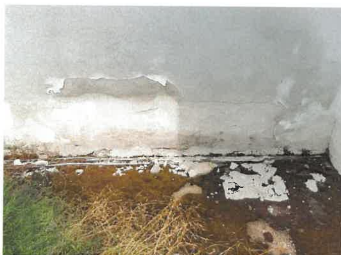
Foto 09) Part. intonaco esterno ammalorato - fronte ovest
