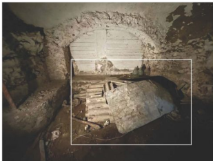
Foto 26 - Vano a nord. Nel riquadro gli scarti di cemento-amiante. In fondo la tamponatura in c.a. che segna il limite ovest della proprietà con la fabbrica adiacente aliena p.lta 103
