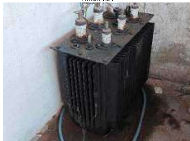
Trasformatore reparto mensa
