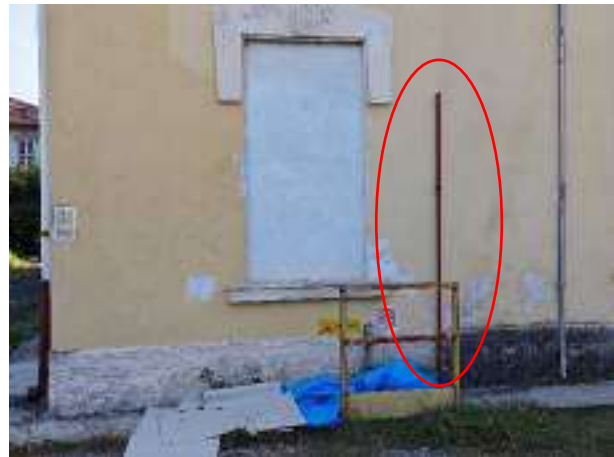
Possibile sfiato serbatoio uffici
