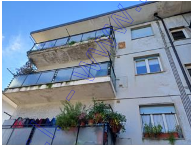
(Facciata Nord con in evidenza il soffitto danneggiato della terrazza al 3° piano)
