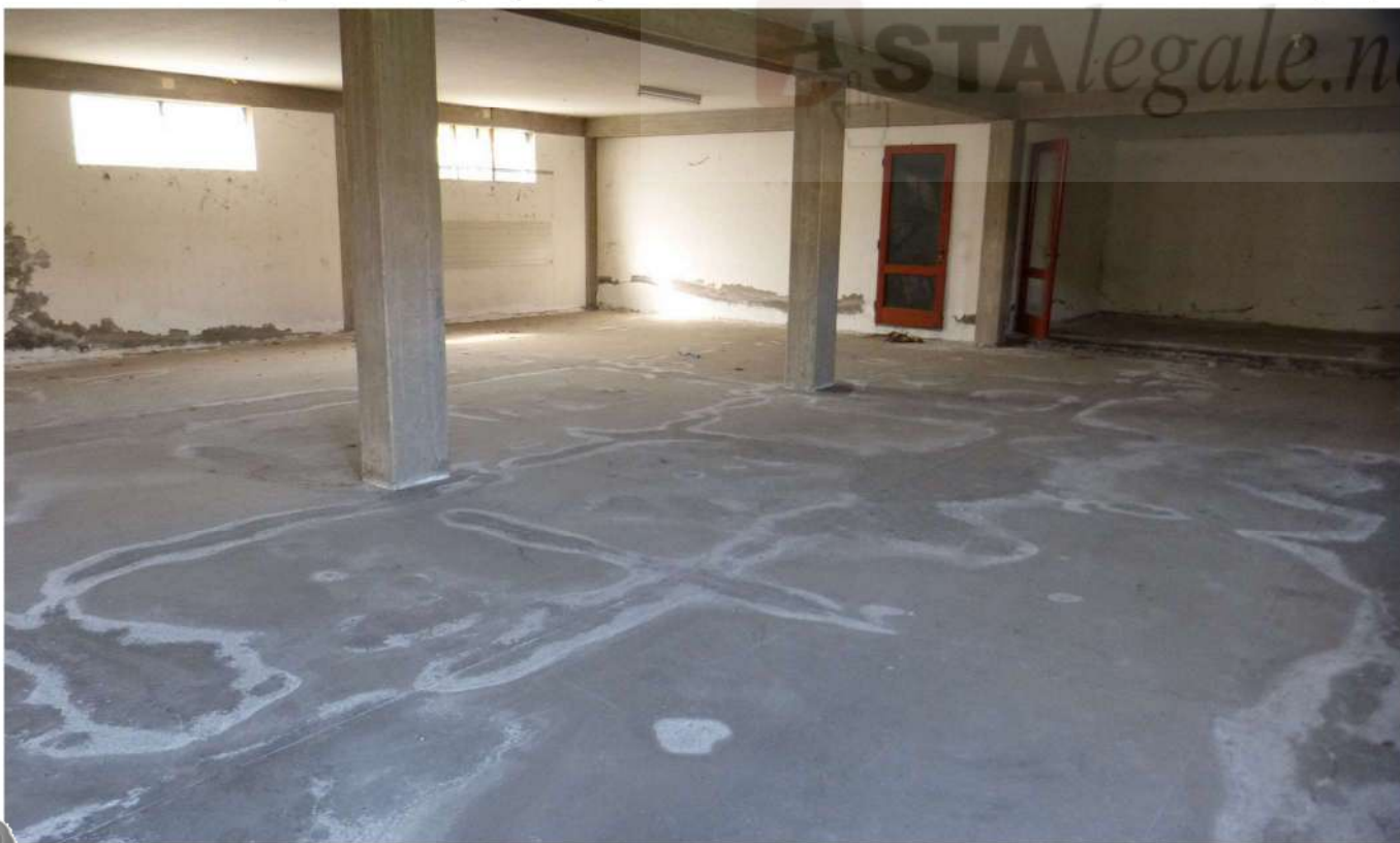
particolare risalta capillare dell'umidità degrado pavimentazione e parti basamentali
