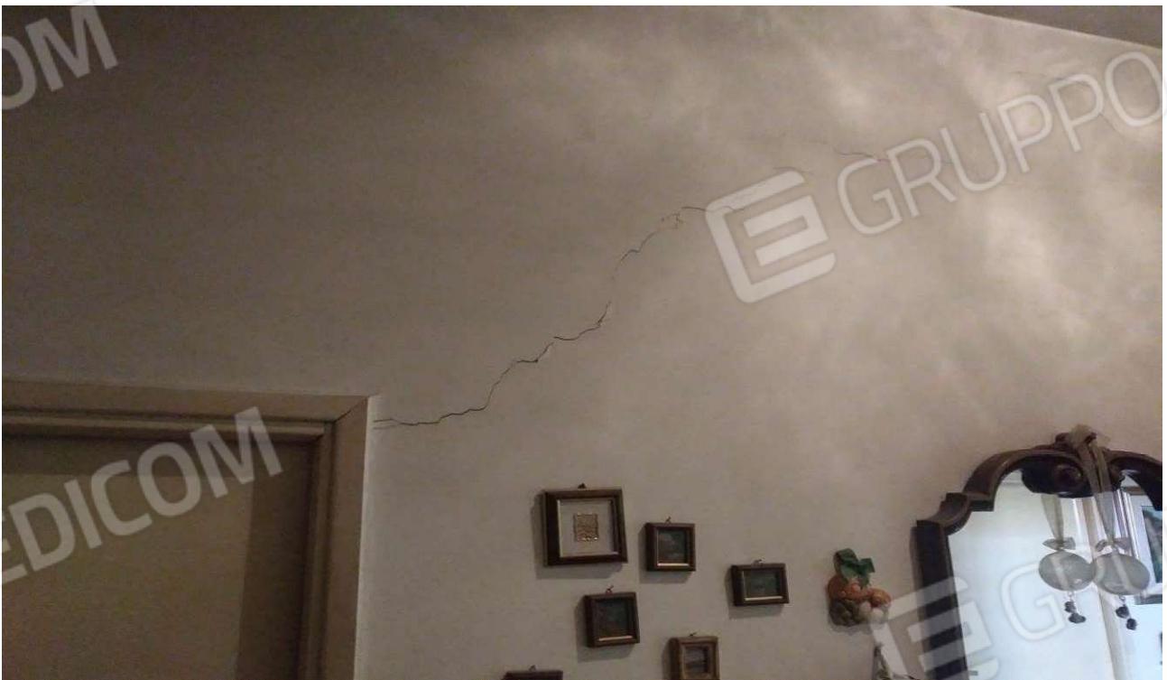
Foto 20 – Crepa muro di tamponatura a destra dell'ingresso, dall'angolo della porta del bagno verso la porta della cucina
