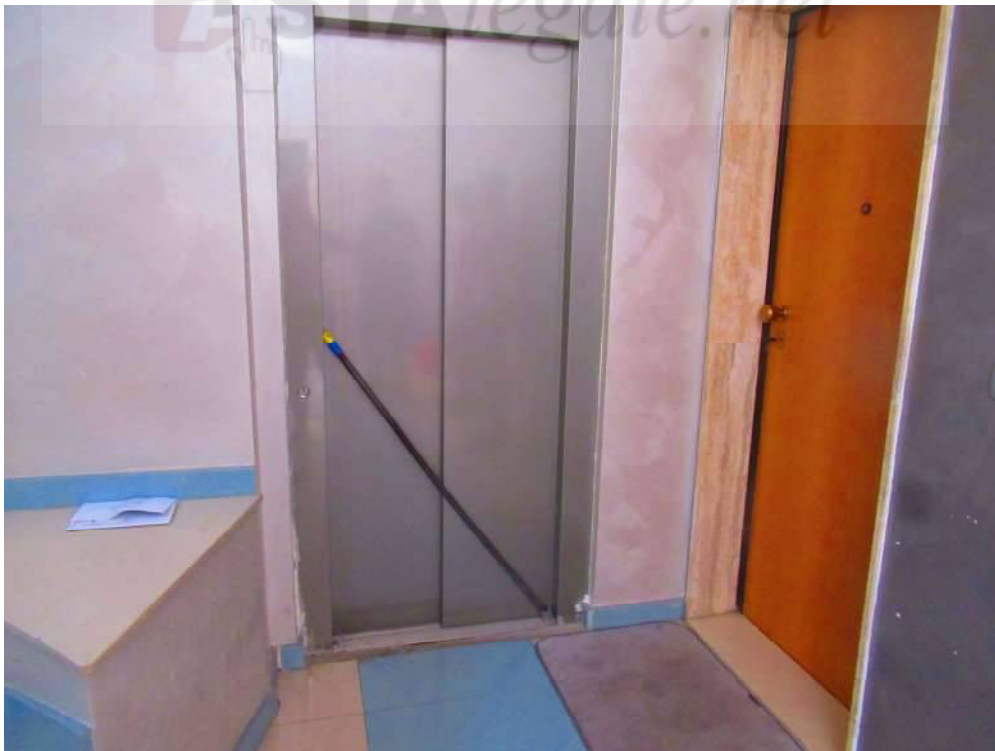
Foto n ° 86 – Ascensore al piano S1. –
