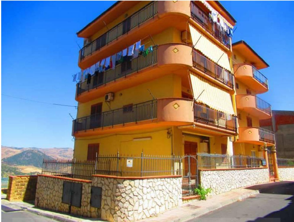
Foto n ° 7 – Vista generale di tutta la palazzina nella sua interezza e complessità . –
