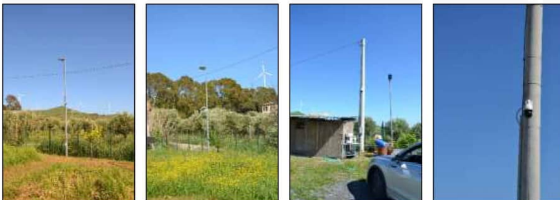
Figura 85 – Impianto videosorveglianza – BENE S2
