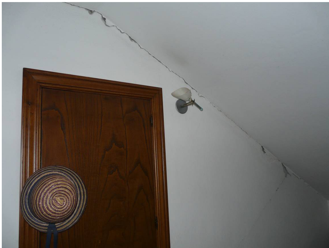
15- particolare lesioni interne
