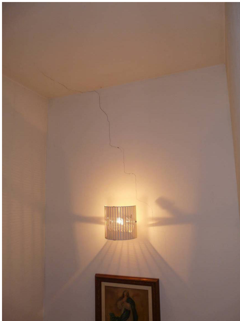
14-particolare lesioni interne
