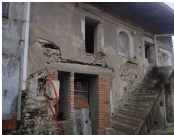
Foto 5 Vista del prospetto Sud del fabbricato ed invito alla scala esterna che porta al piano primo
