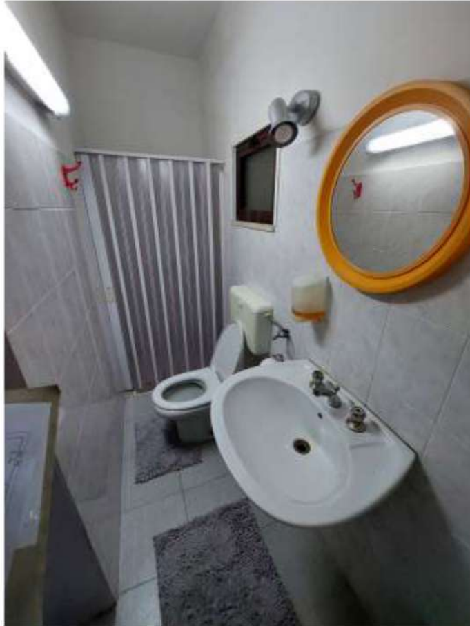
Foto 7 – dall'interno del bagno a p.s.
