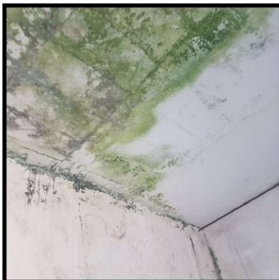
Foto 21 Interni alloggio padronale - Particolare degrado.JPG
