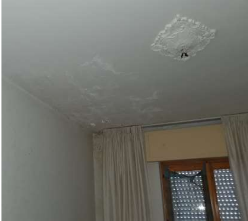
Figura 15 - Particolare infiltrazione Salone
