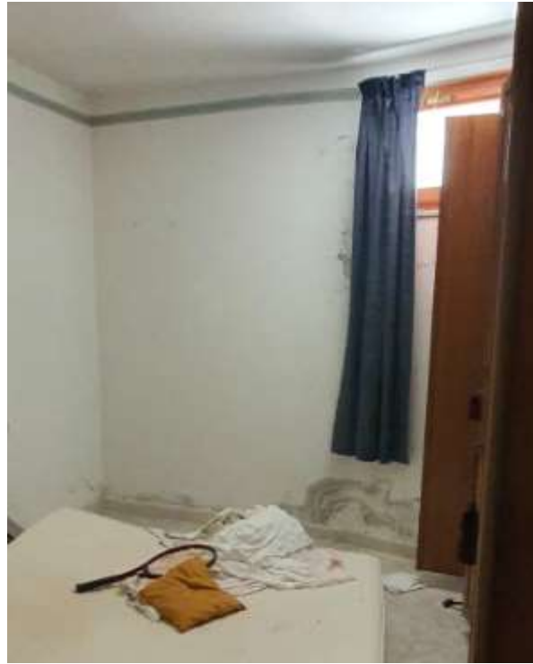
Figura 17 - Particolare infiltrazione Stanza da letto
