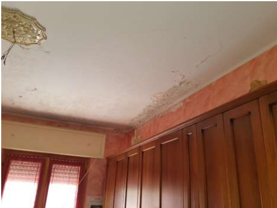
Figura 16 - Particolare infiltrazione Cucina
