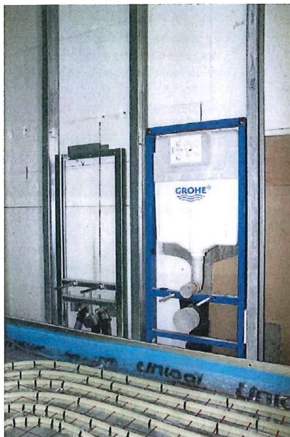
1 Scarico wc e relativa cassetta di scarico
