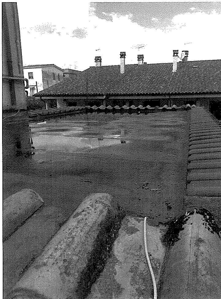
Presenza di acqua sul solaio di copertura
