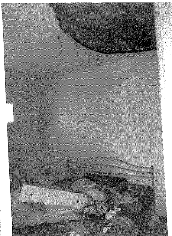
Intonaco crollato soffitto camera
