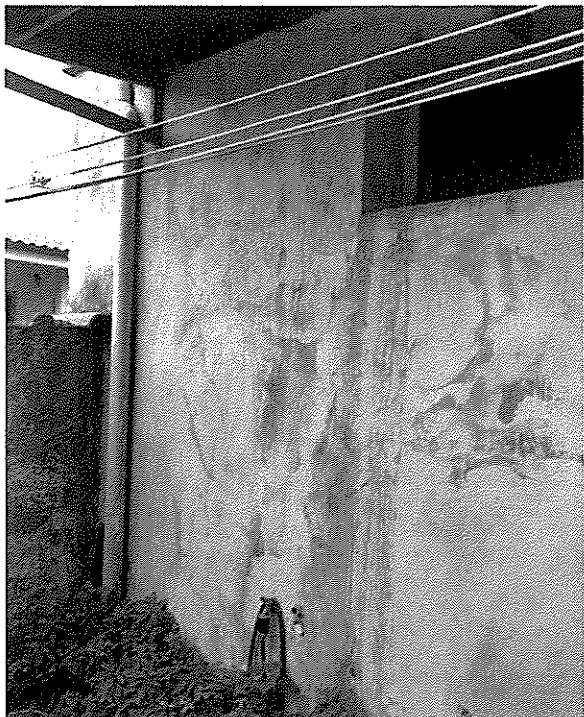
Intonaco esterno ammalorato
