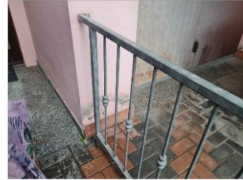
FOTO 60 - PAVIMENTI ESTERNI E UMIDITA' NELLE MURATURE
