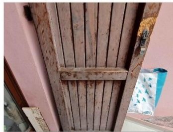
FOTO 62 - SCURONI ESTERNI USURATI
