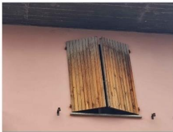
FOTO 61 - SCURONI ESTERNI USURATI
