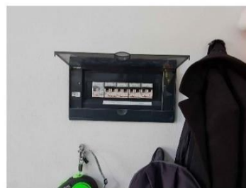
FOTO 54 - QUADRO CONTATORE ENEL
