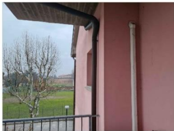
FOTO 50 - PLUVIALI E IMPIANTO CONDIZIONATORE
