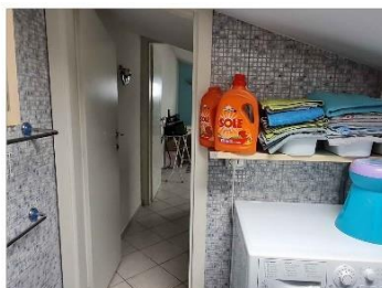
FOTO 41 - BAGNO SOTTOTETTO DIFFORME
