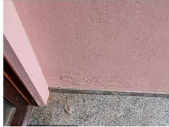
FOTO 59 - UMIDITA' DA RISALITA SULLE MURATURE
