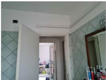
FOTO 49 - IMPIANTO CONDIZIONATORE ZONA NOTTE
