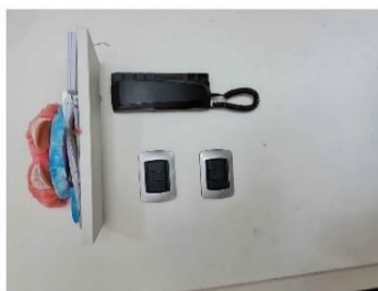
FOTO 53 - CITOFONO E IMPIANTO ELETTRICO
