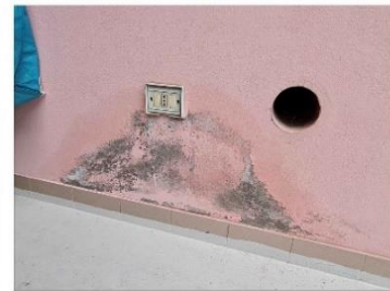
FOTO 63 - UMIDITA' MURATURE SUL BALCONE
