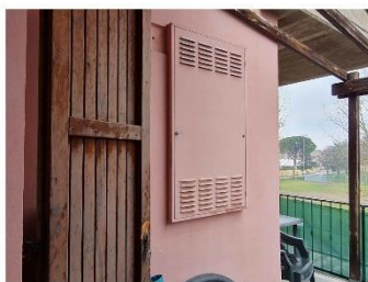
FOTO 28 - CALDAIA IN NICCHIA NELLA MURATURA ESTERNA
