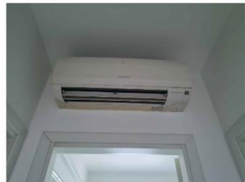
FOTO 51 - UNITA' INTERNA PER IL RAFFRESCAMENTO
