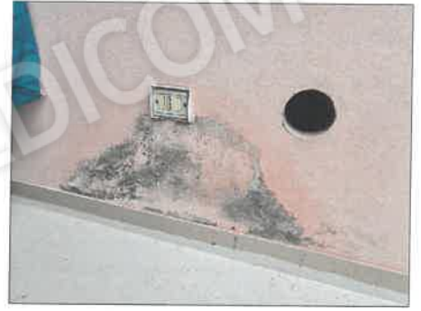
FOTO 63 - UMIDITA' MURATURE SUL BALCONE
