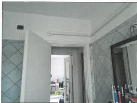
FOTO 49 - IMPIANTO CONDIZIONATORE ZONA NOTTE
