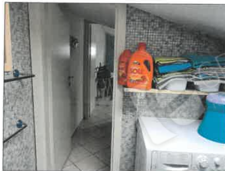
FOTO 41 - BAGNO SOTTOTETTO DIFFORME
