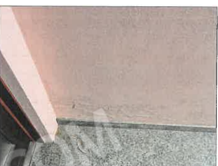
FOTO 59 - UMIDITA' DA RISALITA SULLE MURATURE
