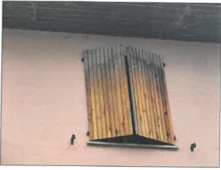
FOTO 61 - SCURONI ESTERNI USURATI
