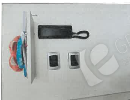
FOTO 53 - CITOFONO E IMPIANTO ELETTRICO
