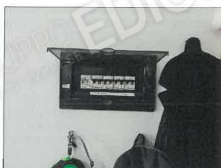
FOTO 54 - QUADRO CONTATORE ENEL
