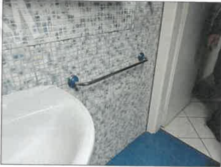
FOTO 64 - RIVESTIMENTO BAGNO SOTTOTETTO
