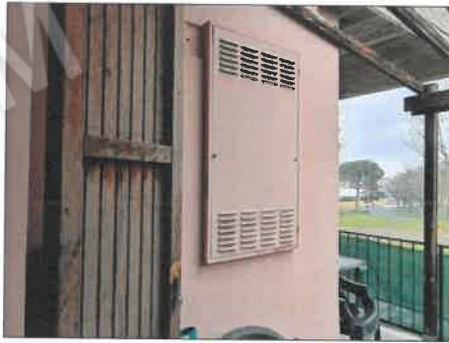
FOTO 28 - CALDAIA IN NICHIA NELLA MURATURA ESTERNA
