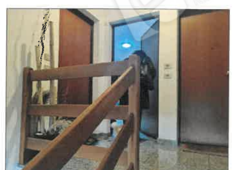
FOTO 24 - PARAPETTO SCALA CONDOMINIALE
