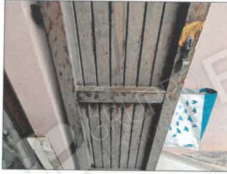
FOTO 62 - SCURONI ESTERNI USURATI
