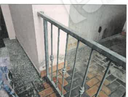
FOTO 60 - PAVIMENTI ESTERNI E UMIDITA' NELLE MURATURE
