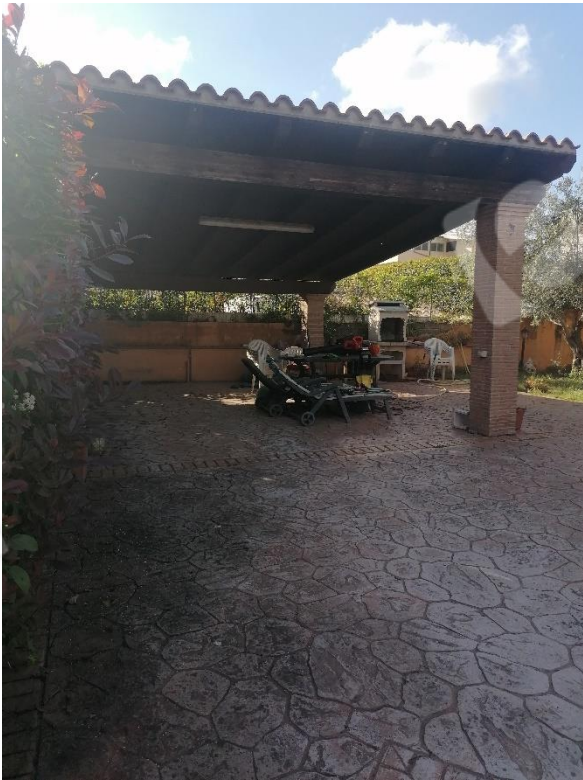
TETTOIA (non autorizzata)
