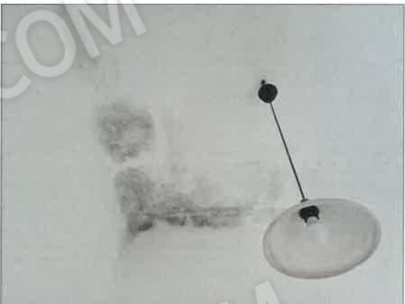
FOTO 29 - UMIDITÀ, CONDENZA E MUFFA NEI SOFFITTI
