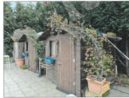
FOTO 60 - CAPANNI NON CONFORMI ACCANTO A PISCINA
