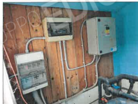
FOTO 66 - CONTATORI IMPIANTI PISCINA
