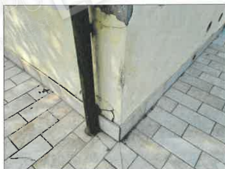
FOTO 82 - FESSURAZIONI, CREPE, DISTACCHI E ROTTURE
