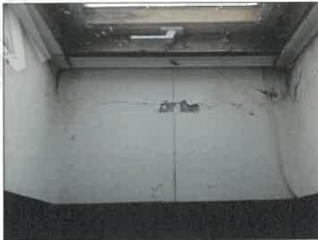
FOTO 100 - LUCERNAIO TETTO INFILTRAZIONI E ASSESTAMENTI
