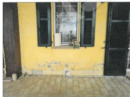
FOTO 72 - UMIDITA' DA RISALITA NEI MURI (INGRESSO PORTICO)
