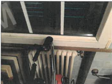
FOTO 136 - RADIATORE ACCIAIO IN NICCHIA
