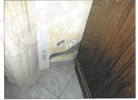
FOTO 105 - INFILTRAZIONI MURI A PIANO TERRA
