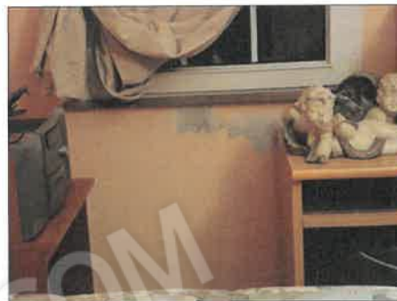
FOTO 107 - INFILTRAZIONE INFISSO CAMERA
