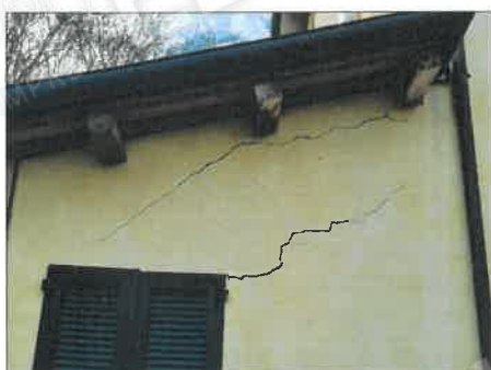
FOTO 70 - CREPE E FESSURAZIONI DI ASSESTAMENTO SISMICO
