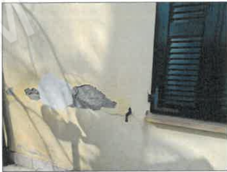
FOTO 76 - DISTACCHI DI INTONACO E VERNICIATURA - UMIDITA'
