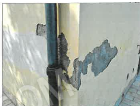
FOTO 71 - DISTACCO DI INTONACO E VERNICIATURA
