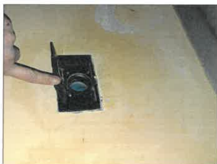
FOTO 140 - IMPIANTO ASPIRAZIONE CENTRALIZZATA
