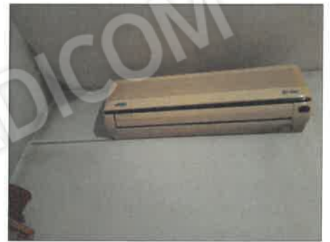
FOTO 135 - UNITA' INTERNA PER IL RAFFRESCAMENTO
