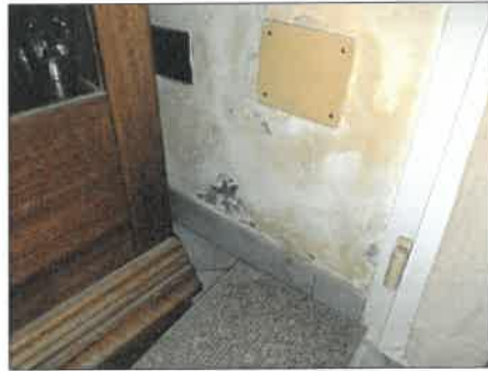
FOTO 104 - INFILTRAZIONI MURO A PIANO TERRA
