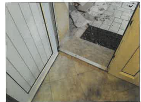
FOTO 96 - SOGLIA E PAVIMENTI INGRESSO
