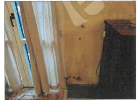
FOTO 108 - INFILTRAZIONI VANI SOGGIORNO
