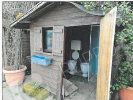
FOTO 62 - BAGNO ABUSIVO IN CAPANNO NON AUTORIZZATO
