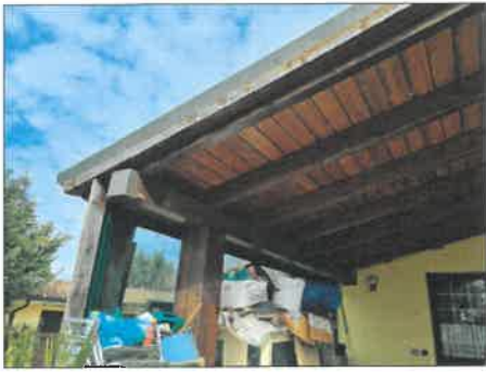
FOTO 73 - PORTICO NON CONFORME
