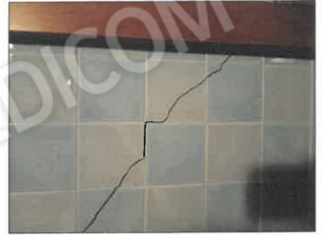
FOTO 99 - CREPE ASSESTAMENTO BAGNO
