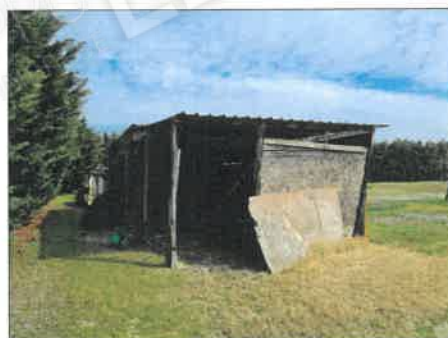
FOTO 46 - CAPANNO NON CONFORME NEL PARCO CIRCOSTANTE
