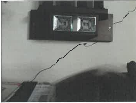
FOTO 97 - FESSURAZIONI E CREPE
