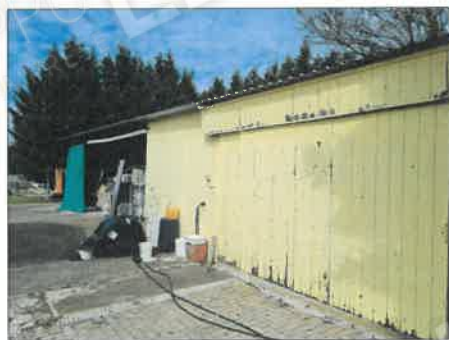
FOTO 34 - MAGAZZINO NON CONFORME INTERNO A CORTE
