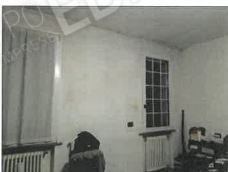
FOTO 142 - SISTEMA DI EMISSIONE RADIATORI IN ACCIAIO
