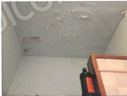
FOTO 103 - UMIDITA' E DISTACCAMENTI INTONACO SOFFITTI
