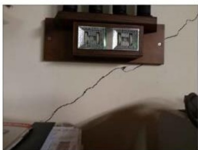
FOTO 97 - FESSURAZIONI E CREPE
