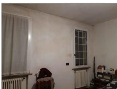
FOTO 142 - SISTEMA DI EMISSIONE RADIATORI IN ACCIAIO
