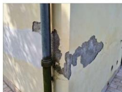
FOTO 71 - DISTACCO DI INTONACO E VERNICIATURA
