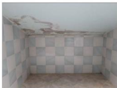
FOTO 101 - INFILTRAZIONI BAGNO SOTTOTETTO
