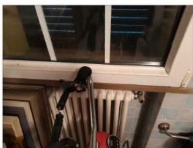
FOTO 136 - RADIATORE ACCIAIO IN NICCHIA
