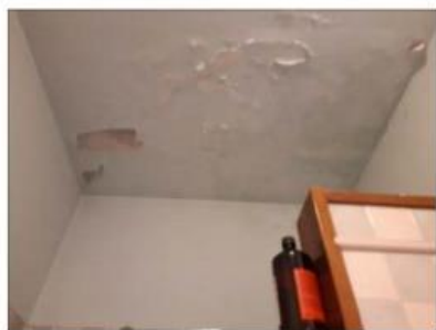
FOTO 103 - UMIDITA' E DISTACCAMENTI INTONACO SOFFITTI
