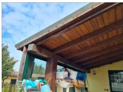
FOTO 73 - PORTICO NON CONFORME
