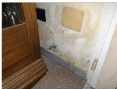
FOTO 104 - INFILTRAZIONI MURO A PIANO TERRA
