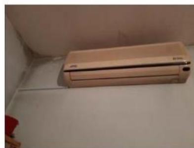
FOTO 135 - UNITA' INTERNA PER IL RAFFRESCAMENTO
