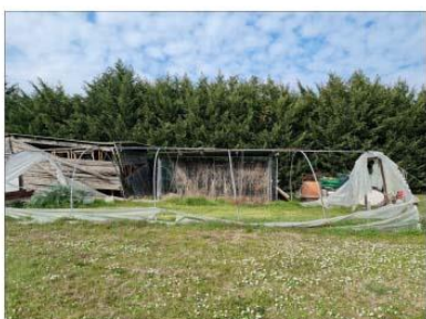
FOTO 49 - CAPANNI E SERRA NON AUTORIZZATI (ANGOLO PARCO)
