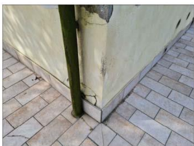
FOTO 82 - FESSURAZIONI, CREPE, DISTACCHI E ROTTURE
