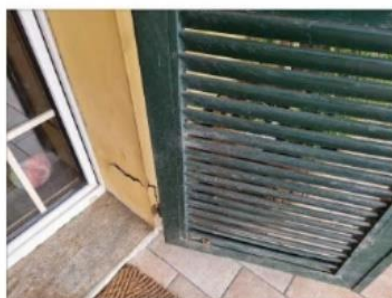
FOTO 80 - CREPE E FESSURE PER SOLLECITAZIONE DA MOVIMENTO
