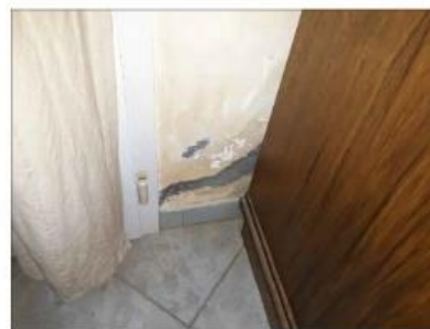
FOTO 105 - INFILTRAZIONI MURI A PIANO TERRA
