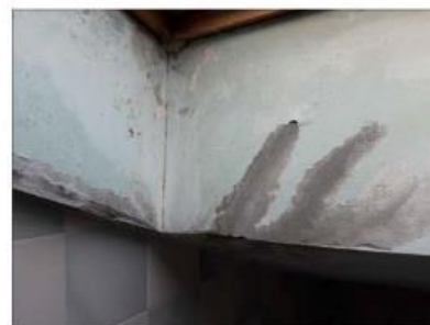
FOTO 102 - INFILTRAZIONI LUCERNAIO IN COPERTURA
