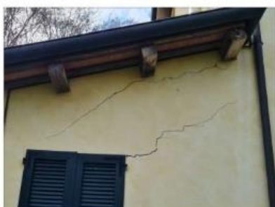
FOTO 70 - CREPE E FESSURAZIONI DI ASSESTAMENTO SISMICO
