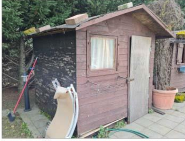
FOTO 61 - CAPANNO NON CONFORME
