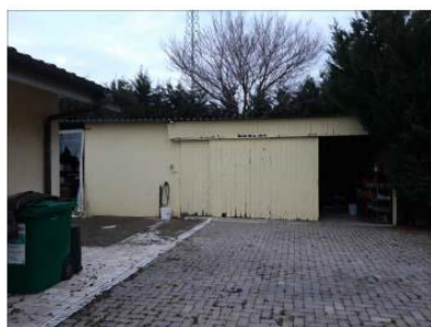
FOTO 35 - VISTA DEL MAGAZZINO NON CONFORME INTERNO ALLA CORTE
