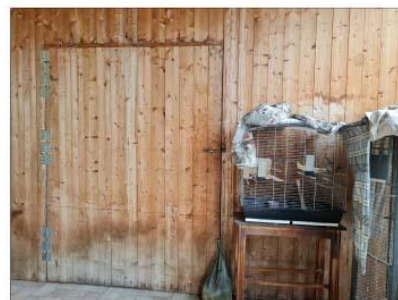
FOTO 75 - PARETE NON CONFORME FRA PORTICO E MAGAZZINO ABUSIVO
