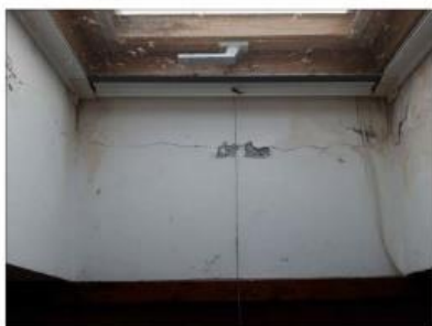
FOTO 100 - LUCERNAIO TETTO INFILTRAZIONI E ASSESTAMENTI
