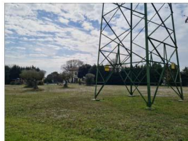
FOTO 45 - TRALICCIO LINEA ALTA TENSIONE NEL PARCO CIRCOSTANTE
