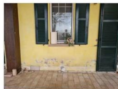
FOTO 72 - UMIDITA' DA RISALITA NEI MURI (INGRESSO PORTICO)
