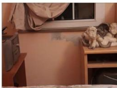
FOTO 107 - INFILTRAZIONE INFISSO CAMERA
