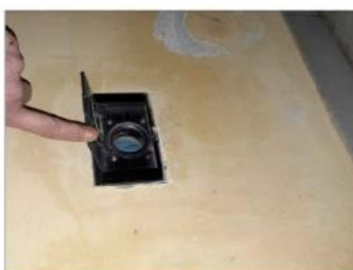
FOTO 140 - IMPIANTO ASPIRAZIONE CENTRALIZZATA
