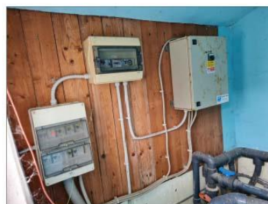
FOTO 66 - CONTATORI IMPIANTI PISCINA
