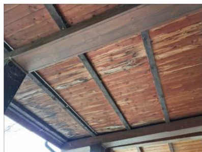
FOTO 74 - PERGOLATO TRASFORMATO IN TETTOIA/PORTICO
