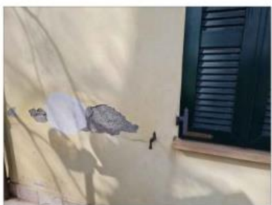
FOTO 76 - DISTACCHI DI INTONACO E VERNICIATURA - UMIDITA'
