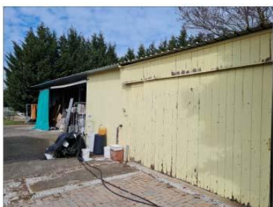
FOTO 34 - MAGAZZINO NON CONFORME INTERNO A CORTE
